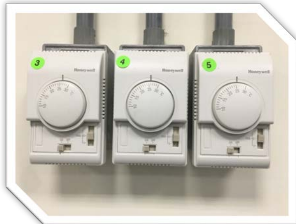
空調採用恆溫裝置
